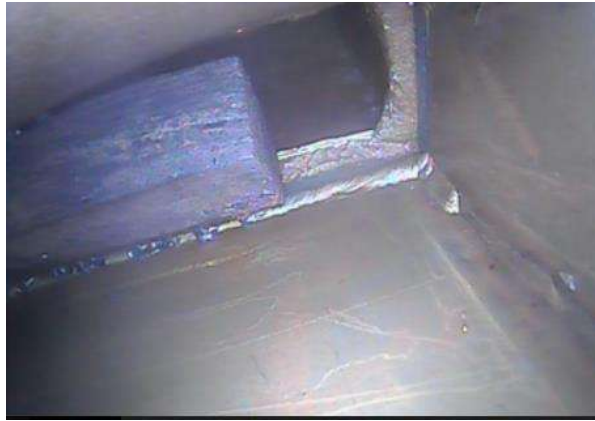
photo du siphon totalement colmaté empêchant tout lavage de filtre ( passage de quelque centimètres au lieu d'environ 1 mètre habituellement )
